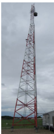
La tour de télécommunications ressemblera à la photo ci-dessus.
